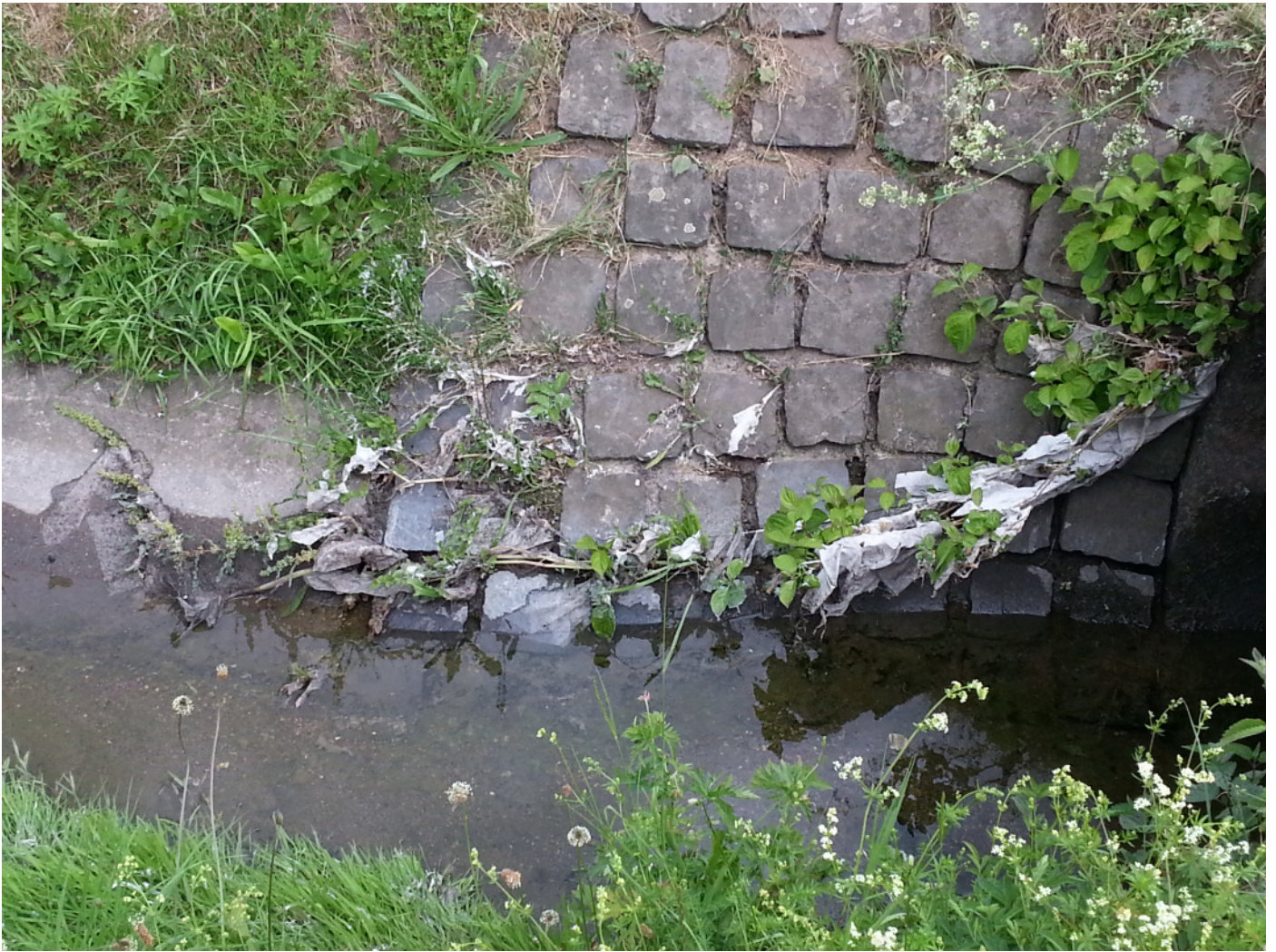
Austritt kanal hinter den Unterführungen
