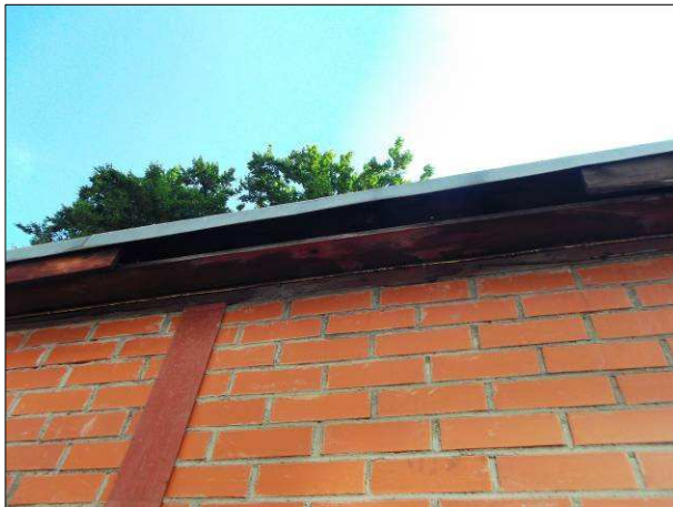
Abb. 15: Hohlräume durch marode Verkleidungen an der Dachaußenkante eines kleinen Gebäudes auf dem Poppe-Gelände
