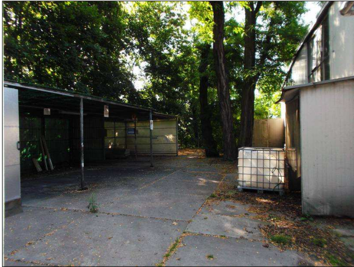
Abb. 12: Hinter dem Nachbargebäude des Kesselhauses stehen drei alte Eschen, die die Betonplatten durchbrochen.
