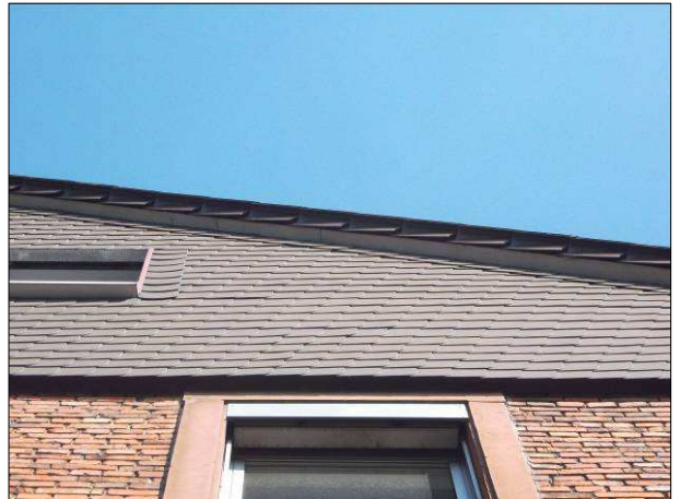
Abb. 14: Abstehende Dachschindeln des ehemaligen Verwaltungsgebäudes
