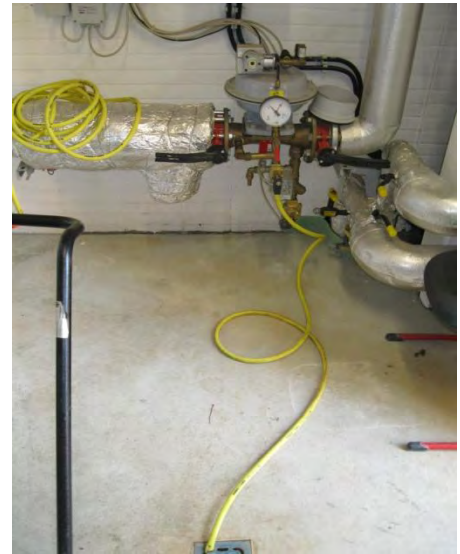
Druckregler im Technikraum Haus C
